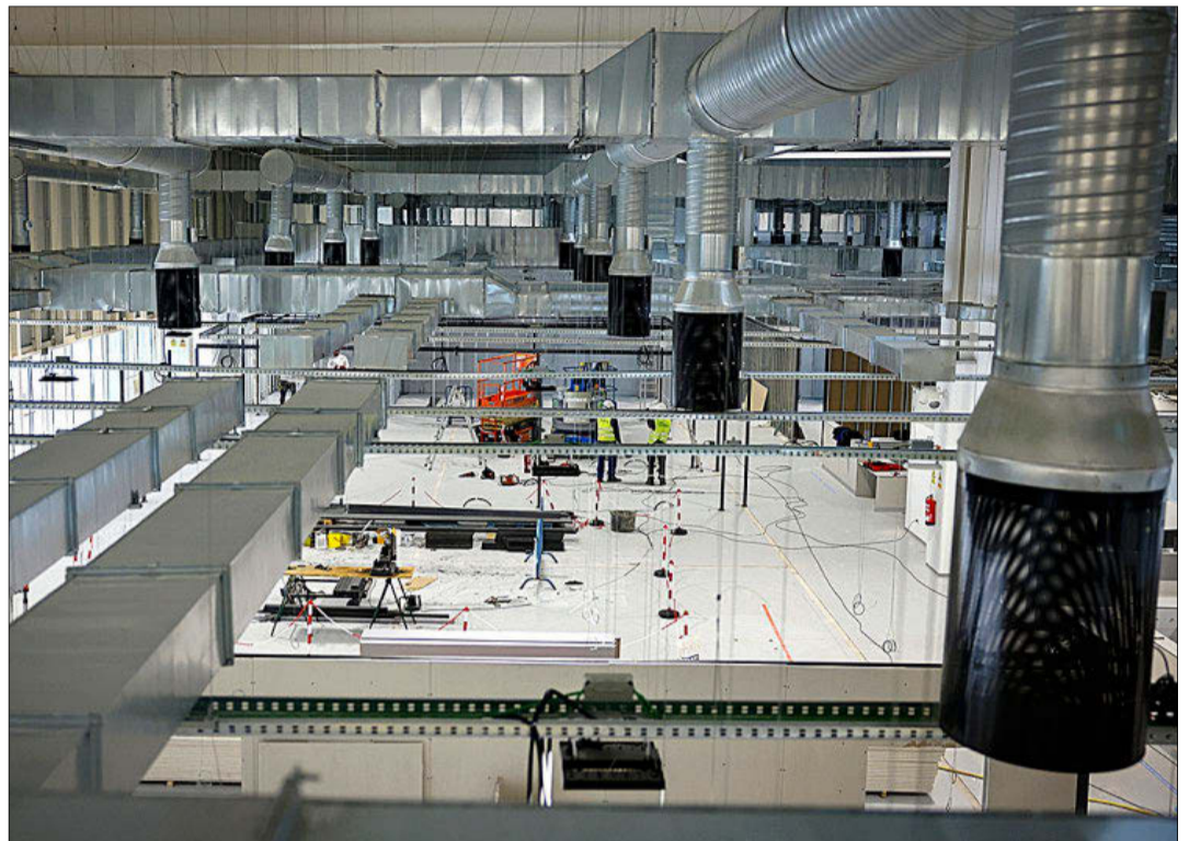
El inicio de las obras del Centro Especializado de Atención Diurna, estos días pasados. CAM
